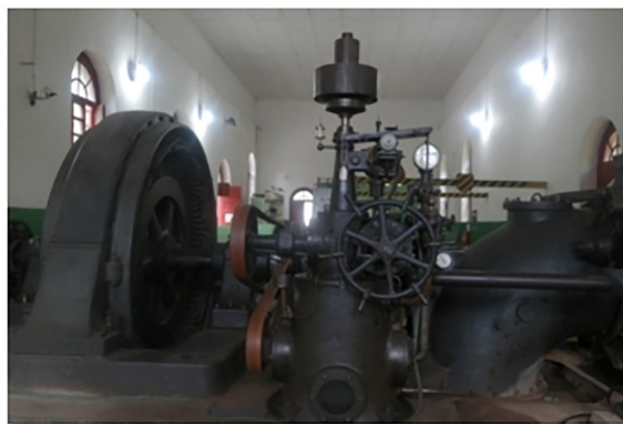
图11 中国的第一座水力发电站（诸锡斌2020年拍摄于石龙坝水电站）
